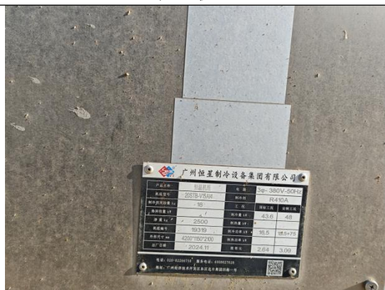
恒温机组铭牌
